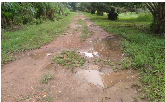
๑๑.โครงการซ่อมแซมถนนลูกรังสายบ่อประมง ม.๖ ภาพก่อนดำเนินการ
